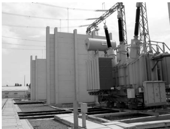
Рис. 3. Силовой трансформатор предприятия «Днепросталь»
