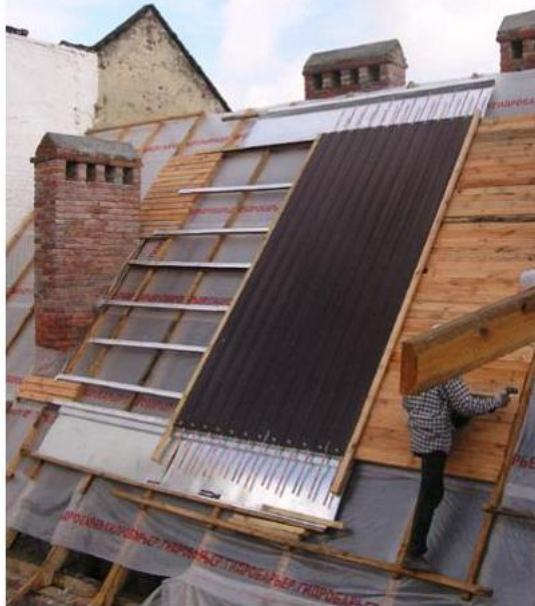
Рис.2 Фрагмент енергоактивного даху з геліопрофілю
