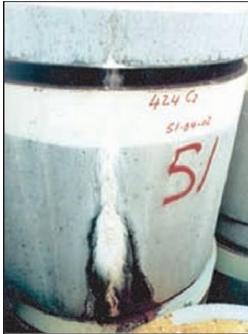
Вилуговування бетонного контейнера ґрунтовими водами
