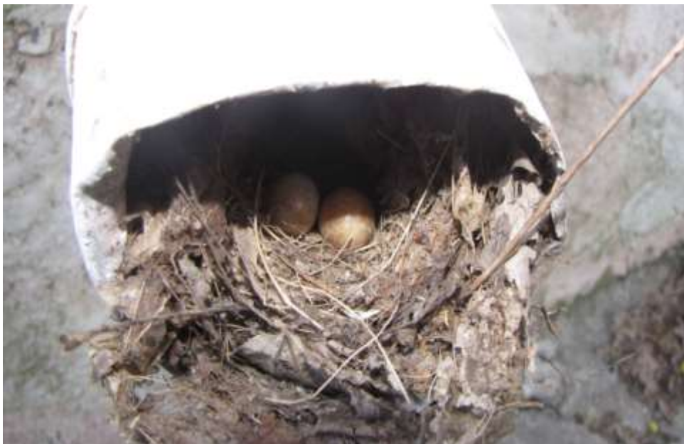
Дод. Д 41. Гніздування вільшанки у водостічній трубі будинку у рекреаційній зоні НПП «Гомільшанські ліси» (діброва III ст. рекр.)
